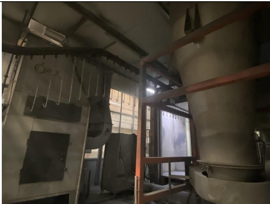
喷塑废气处理设施：旋风+布袋除尘器 DA002
