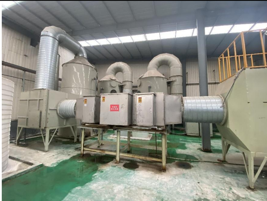
电泳、电泳烘干和喷塑烘干废气处理设施：喷淋塔+uv+二级活性炭 DA003
