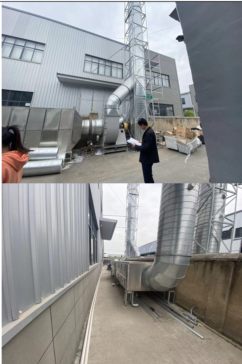
注塑废气、塑料合成废气处理设施：两套二级活性炭合并排放 DA007
